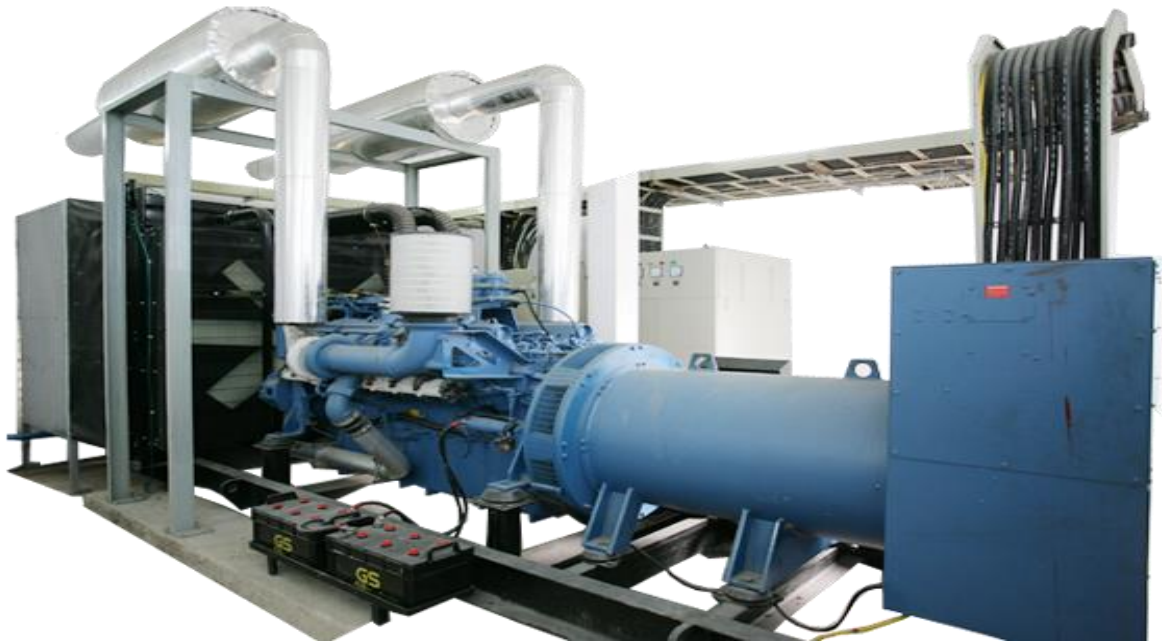
Hình 4-2: Hệ thống máy phát điện
